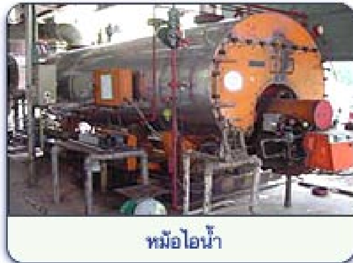
รูปที่ 4.1 หม้อไอน้ำ (Boiler)
