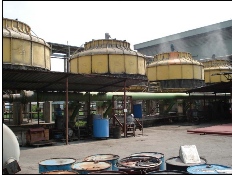
รูปที่ 5.4 หอผึ่งน้ำหล่อเย็นเครื่องจักร
